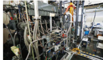
ガスエンジン
