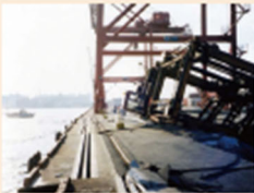
兵庫県南部地震の被害
