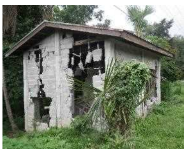
地震被害を受けたフィリピンの CHB 造住宅
