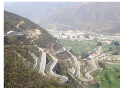
シンズリ道路 (第3工区第2期建設工事・ 第2工区斜面对策工事)
