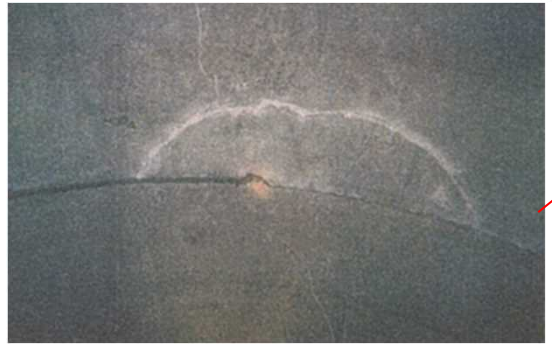
目地部に連結する半月状のひび割れ
