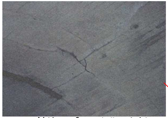
ひび割れでブロック化した例
