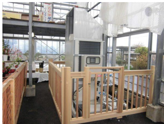
導入したヒートポンプ
