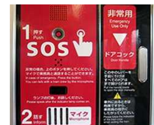
非常通報装置の設置例
