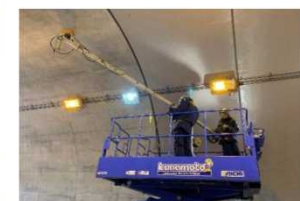
レーダーを利用したトンネル覆工の損傷把握
