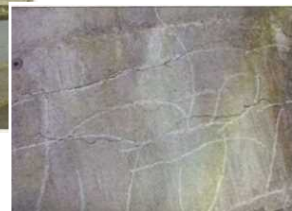
下部工のひび割れ
