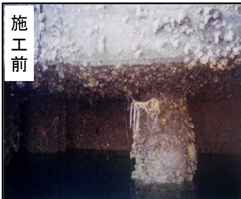
鋼管杭が塩害により腐食
