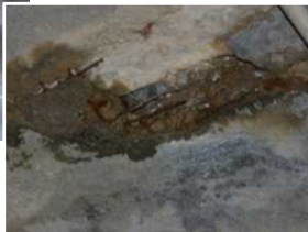
覆工コンクリートの剥落・貫通ひびわれ
