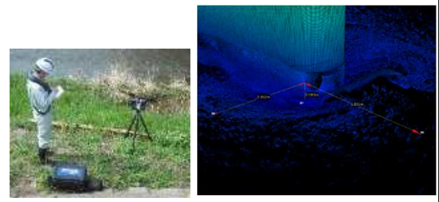
3次元座標データの取得による下部工の洗掘状況把握 <掲載技術名> スキャニングソナーとレーザースカナによる橋梁基礎形状計測技術 (検出項目:3次元座標)
