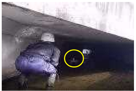
水面から動画撮影を実施し損傷状況を把握 <掲載技術名> 水面フローターと360°カメラを搭載したドローンによる溝橋の点検 (検出項目:ひびわれ)
