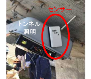
トンネル内附属物の異常監視センサー
