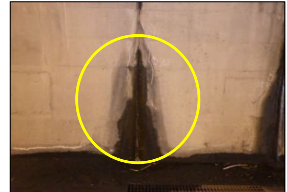
【覆工からの漏水】
