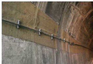
▲ 繊維シートの接着(劣化により落下が懸念)
