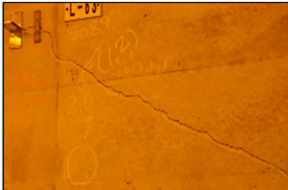
【覆工のひび割れ】
