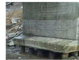
杭基礎の露出
