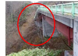
斜面上基礎の洗堀
