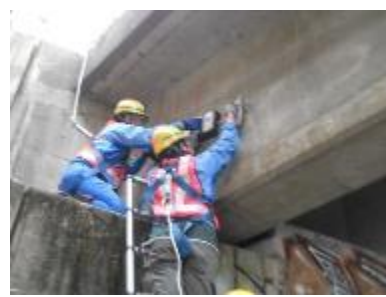
磁気磁束密度を測定し内部の損傷を把握 <掲載技術名> 磁気による鋼材破断の非破壊検査法(SenrigaN)
