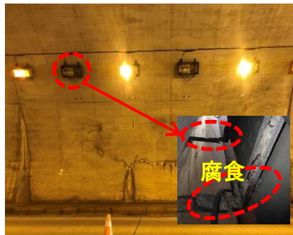
▲ 附属物取付部の腐食
