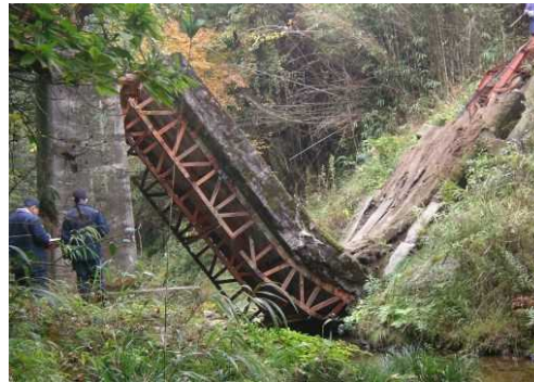
写真1 老朽化が原因で落橋した国内事例
