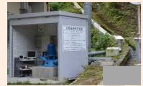
小水力発電設備
