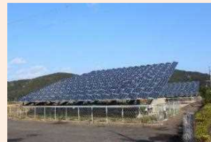
太陽光発電設備
