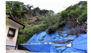
豪雨の度に土砂崩れが多発
