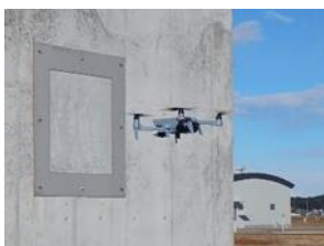
ドローンによる損傷把握
