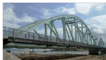
ハノイ～ホーチミン間鉄道橋梁 安全性向上工事 (CP1D, CP2, CP3A)
