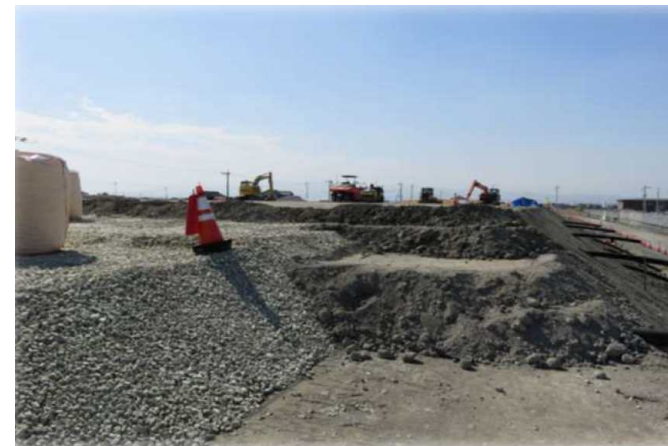
出典)「スーパーソール適用事例:混合軽量土・サンドウィッチ式の事例」 (ガラス発泡資材事業協同組合)
