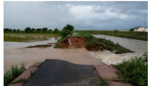
川水系鍋谷川の堤防決壊 （石川県小松市）
