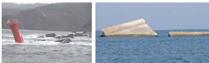
図 2.3-1 第一線防波堤の被災（釜石港 湾口防波堤）
