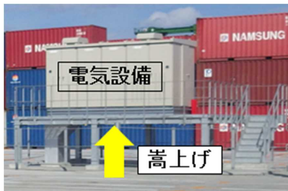
図 2.3-11 電気設備の嵩上げ事例
