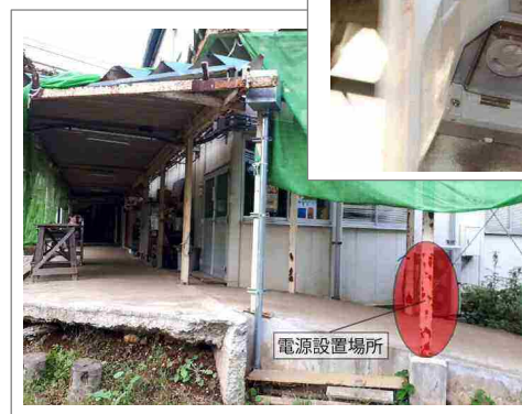
充電設備の状況
