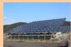
再エネ発電設備
