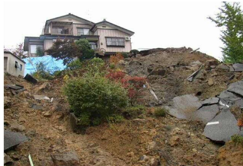
図-2 盛土造成地の滑動崩落②（長岡市高町）
