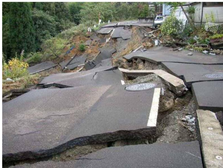
図-1 盛土造成地の滑動崩落①（長岡市高町）
