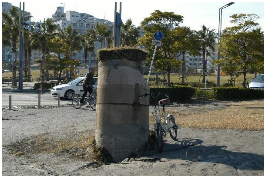
図-3 マンホールの浮き上がり
